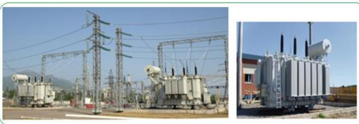
4.1.1–rasm. Elektr ta'minitida qo'llaniladigan kuch transformatorlari Transformatorlar ishlatilishiga qarab bir necha xilga bo'linadi:
